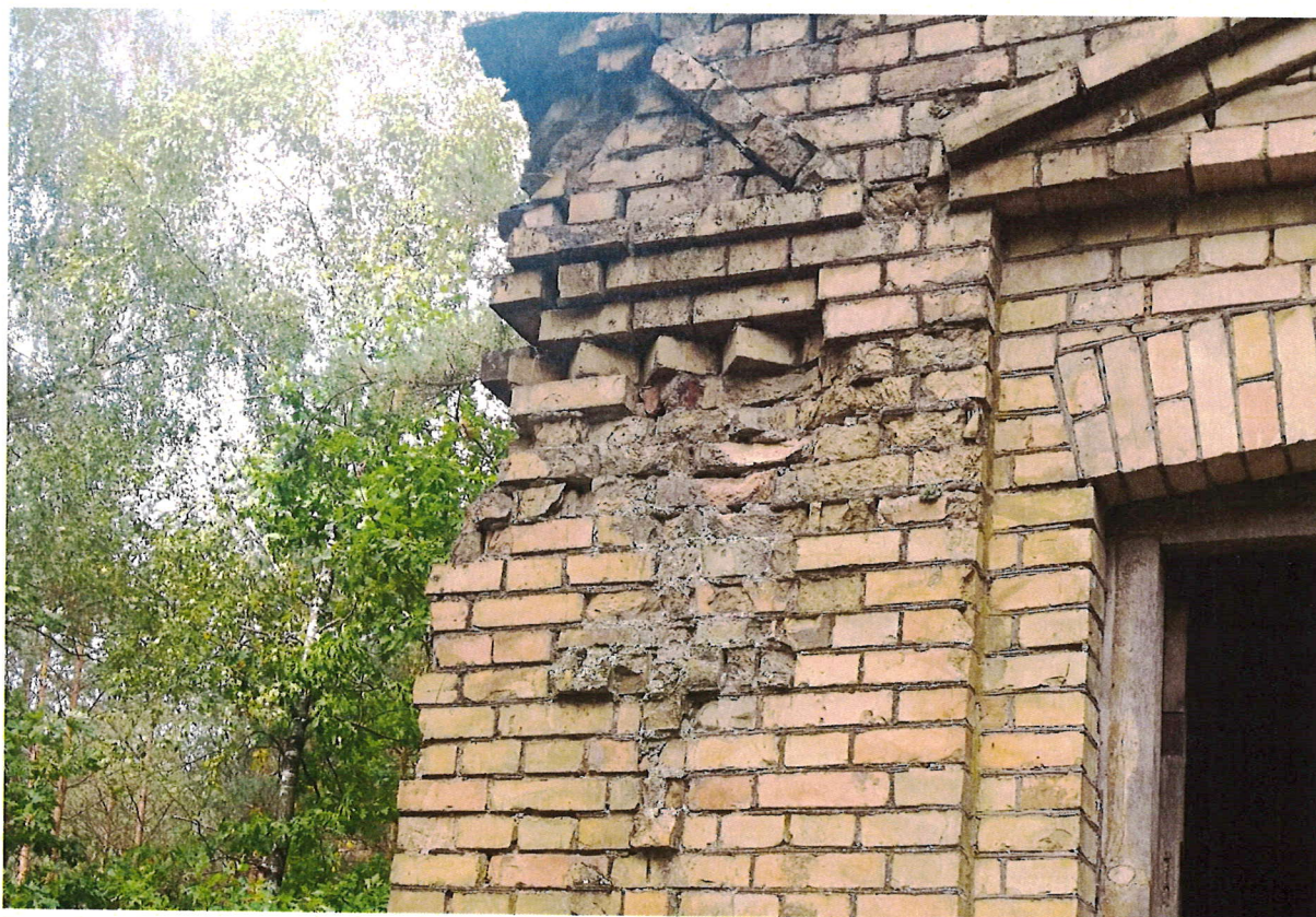
ZDJ.4 Widok narożnika. Widoczne zniszczenia cegieł
