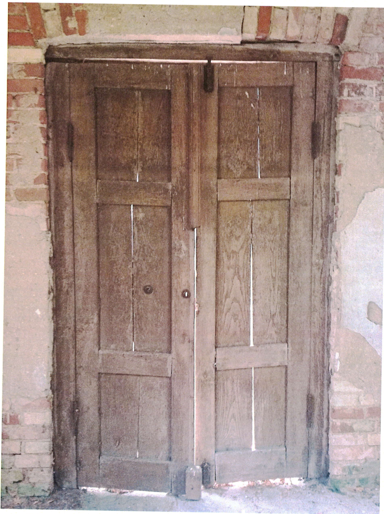
ZDJ.14 Detal drzwi. Deski są w dobrym stanie technicznym drzwi mogą być naprawione.
