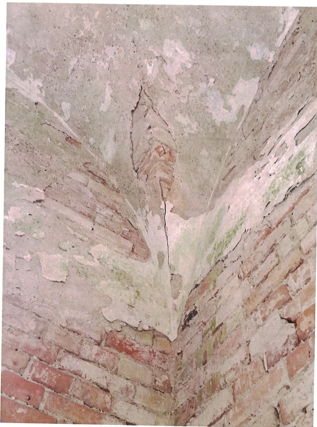
ZDJ.11 Ściany wewnętrzne i sufit łukowy. Widoczne bardzo duże ubytki w tynku i spoinie cegieł
