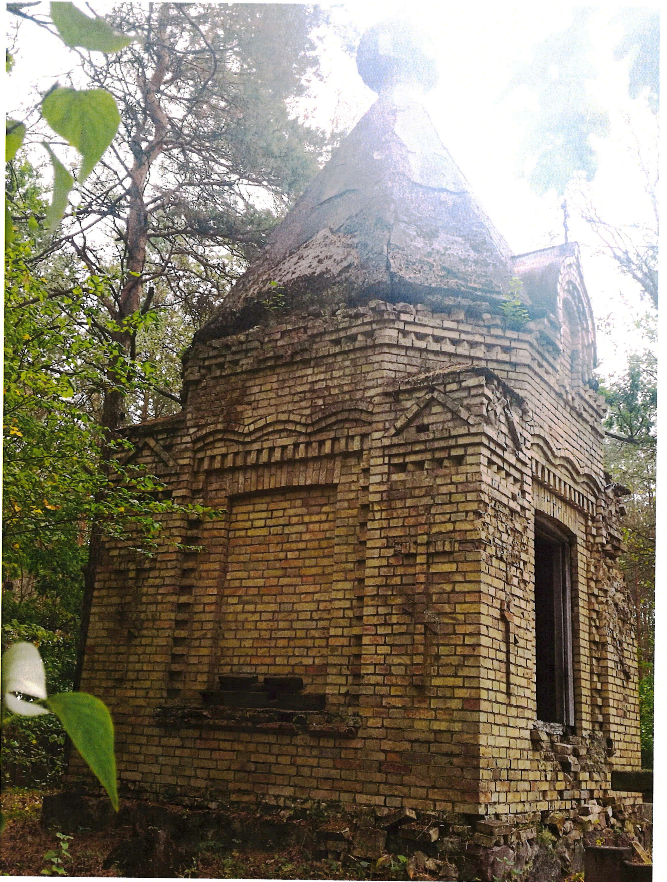
ZDJ.3 Widok elewacji północno – wschodniej i północno – zachodniej (z oknem). Widoczne zniszczenia elewacji
