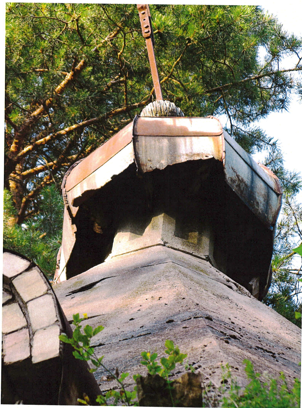
ZDJ.15 Elementy drewniane kopuły są całkowicie zniszczone. Blacha na kopule opadła i utrzymuje się na resztkach konstrukcji
