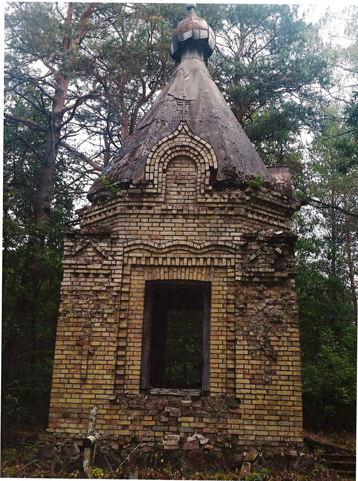
ZDJ.2 Widok elewacji południowo – zachodniej. Widoczne zniszczenia elewacji
