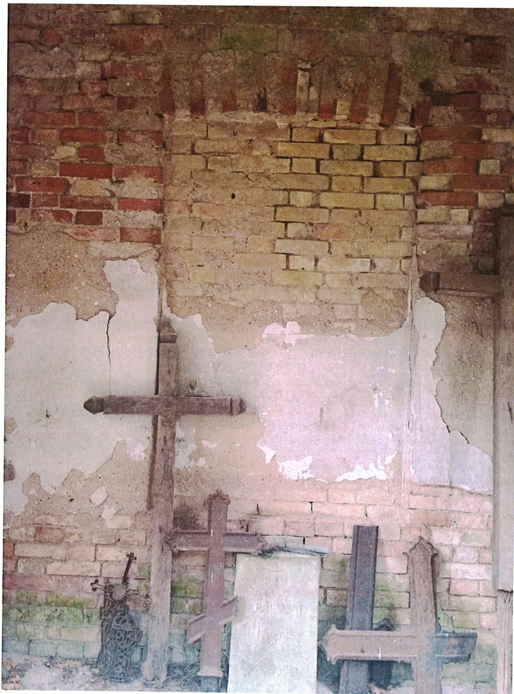
ZDJ.9 Ściany wewnętrzne. Widoczne bardzo duże ubytki w tynku i spoinie cegieł.
