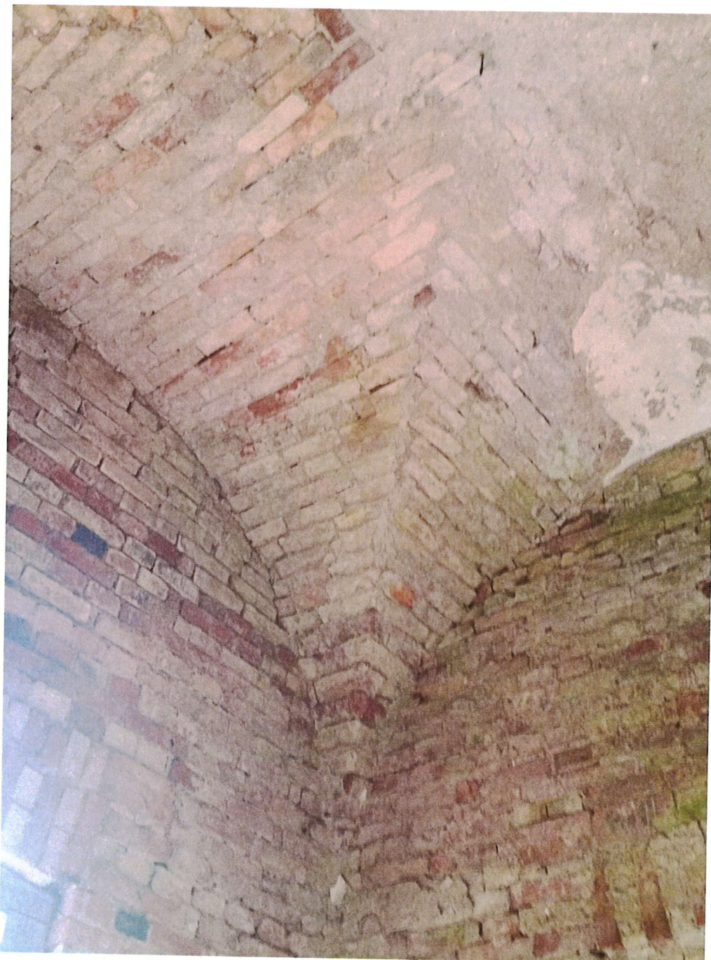
ZDJ.10 Ściany wewnętrzne i sufit łukowy. Widoczne bardzo duże ubytki w tynku i spoinie cegieł
