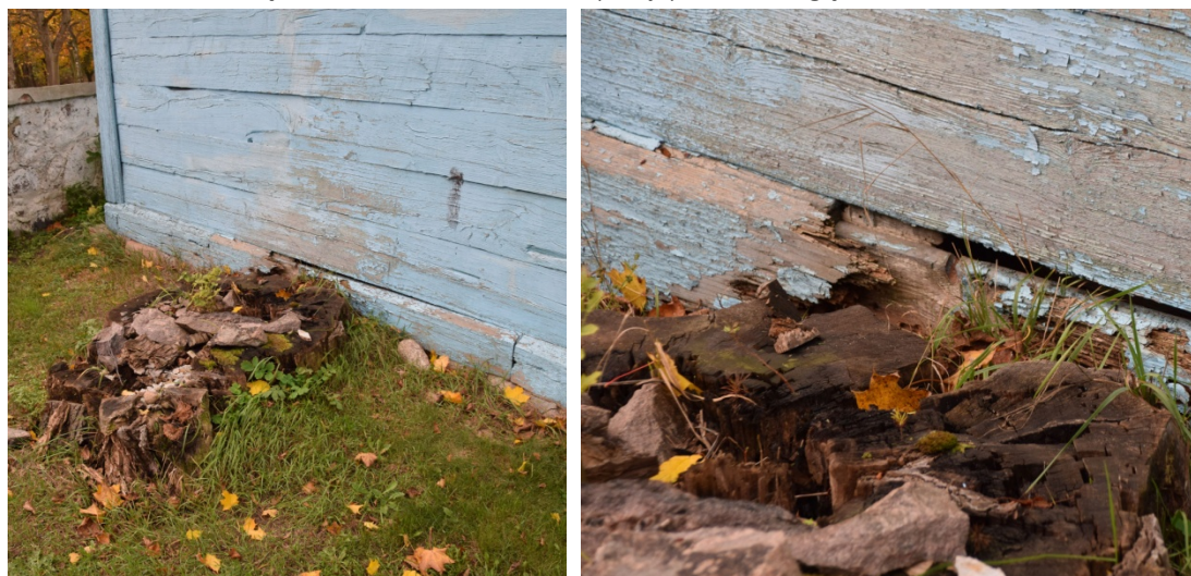
Podwalina zniszczona przez korzeń drzewa
