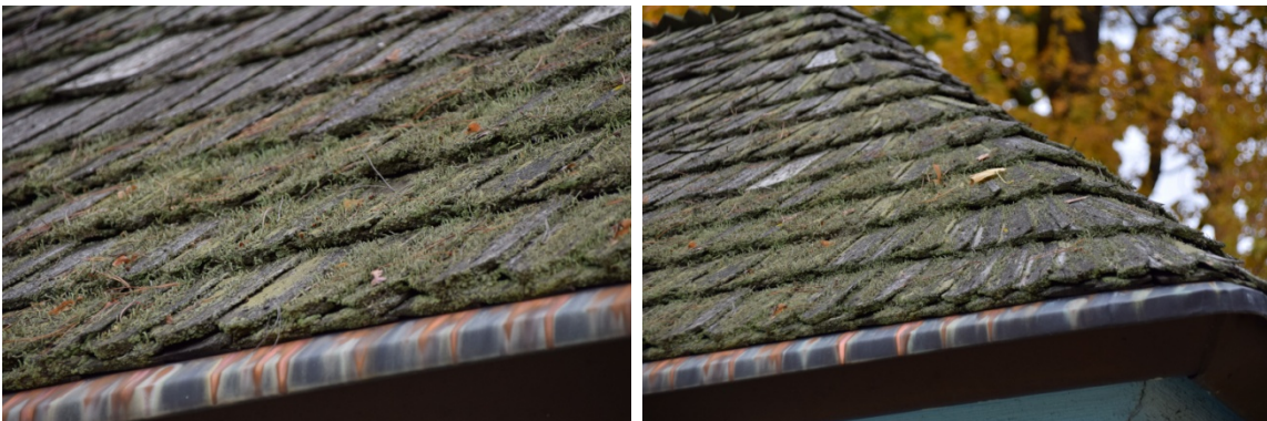
Pokrycie z gontów które nie zapewnia szczelności
