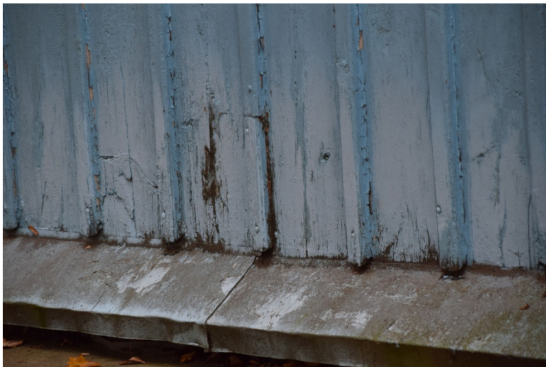
Stan szalówek zewnętrznych i łuszczenie się powłok malarskich
