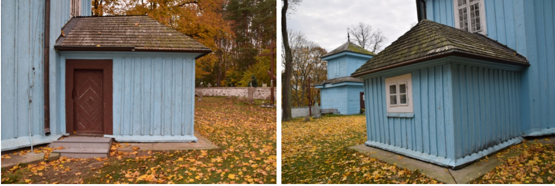
Widoczne osiadanie i deformacja dachu
