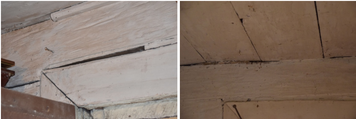
Widoczna deformacja ścian
