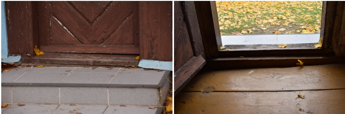
Wyraźne nachylenie podłogi
