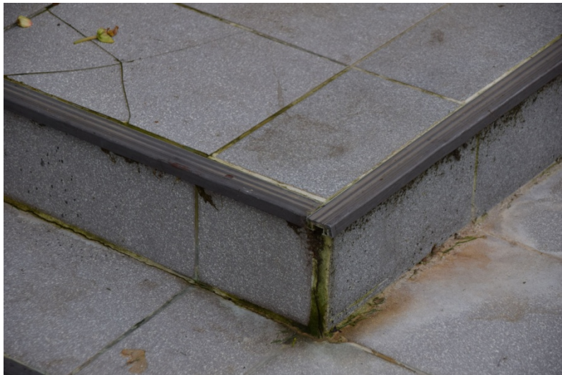
Schody obłożone płytkami gresowymi z plastikowymi obrzeżami, spękane.
