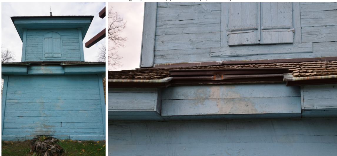
Wcięcie w dachu. Przerwanie deski okapowej spowodowało ugięcie zadaszzenia.
