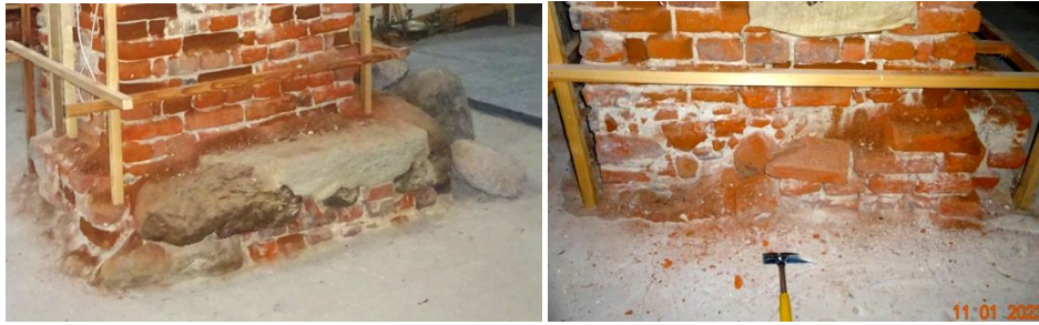
Fot.30 Uszkodzona podstawa filara Nr2 ....
