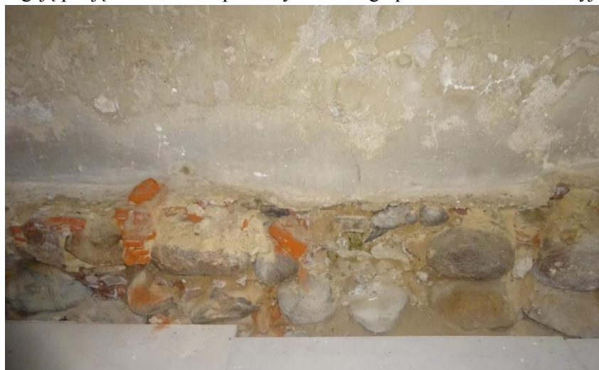
Fot.3 Fragment fundamentu z głazów kamiennych z uszkodzonym wiązaniem. Wstawki z cegły pełnej. Na tynku –sole budowlane (termatyt)
