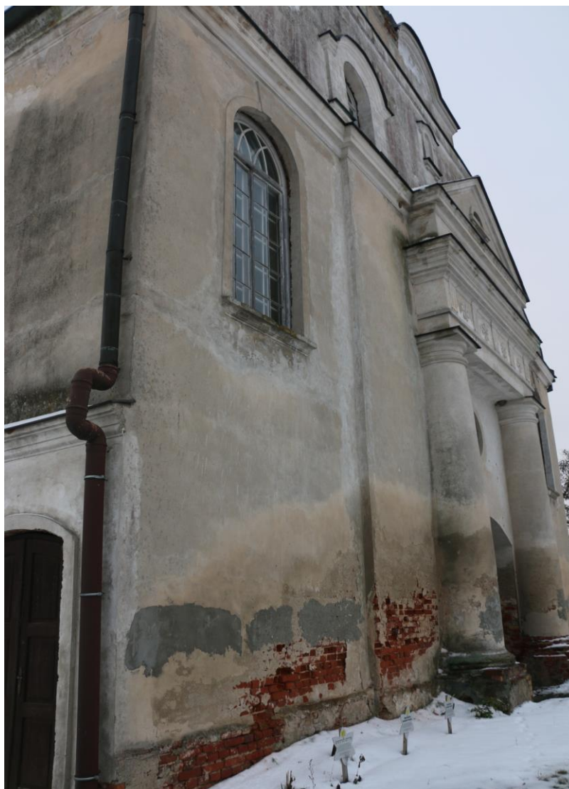
Fot.26 Zdegradowany fragment zachodniej elewacji frontowej
