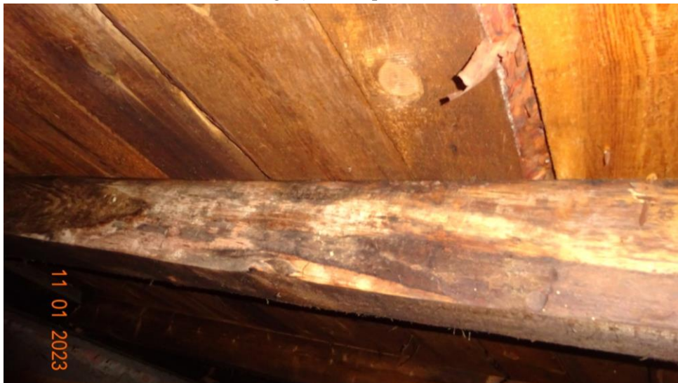
Fot.19 Powierzchniowe uszkodzenie krokwi i desek przez owady –szkodniki drewna budowlanego ( Anobium punctatum ) . Nieprecyzyjna impregnacja
