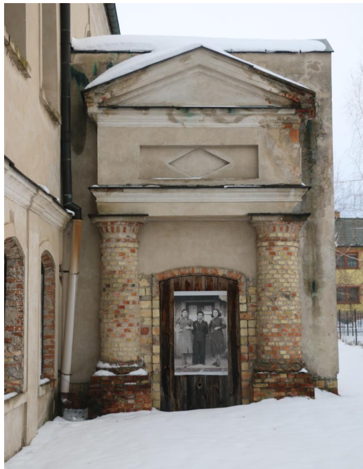
Fot. 28 Wejście do babińca południowego Niewłaściwie wykonane obróbki blacharskie i zbyt wysoki poziom terenu przyczyną zamakania ścian oraz rozwoju Glonów ( algae ) PRÓBKA NR 6
