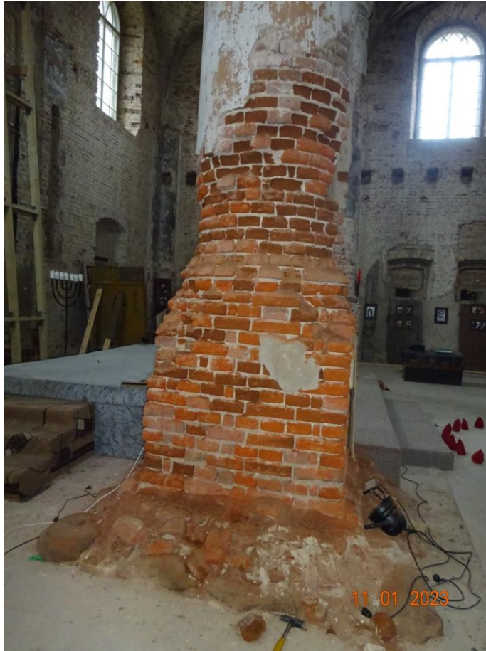
Fot. 12 Filar Nr 3 Uszkodzone wiązanie i sam materiał konstrukcyjny podstawy . Liczne sole węglanowe i azotanowe(?)
