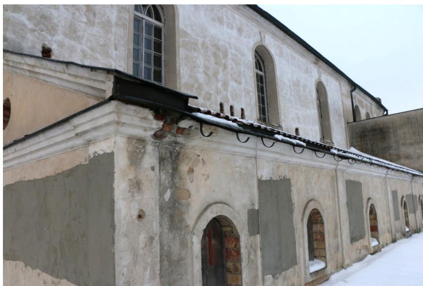
Fot.21 Zdemontowane rynny i rura spustowa po stronie północnej budynku
