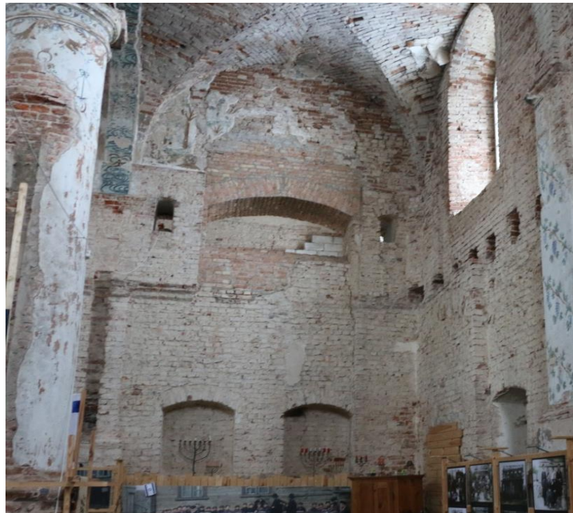
Fot.7 Narożnik ściany środkowej (w osi D-D) ze ścianą podłużną (w osi A-A) Widoczne pionowe i skośne spękania struktury muru
