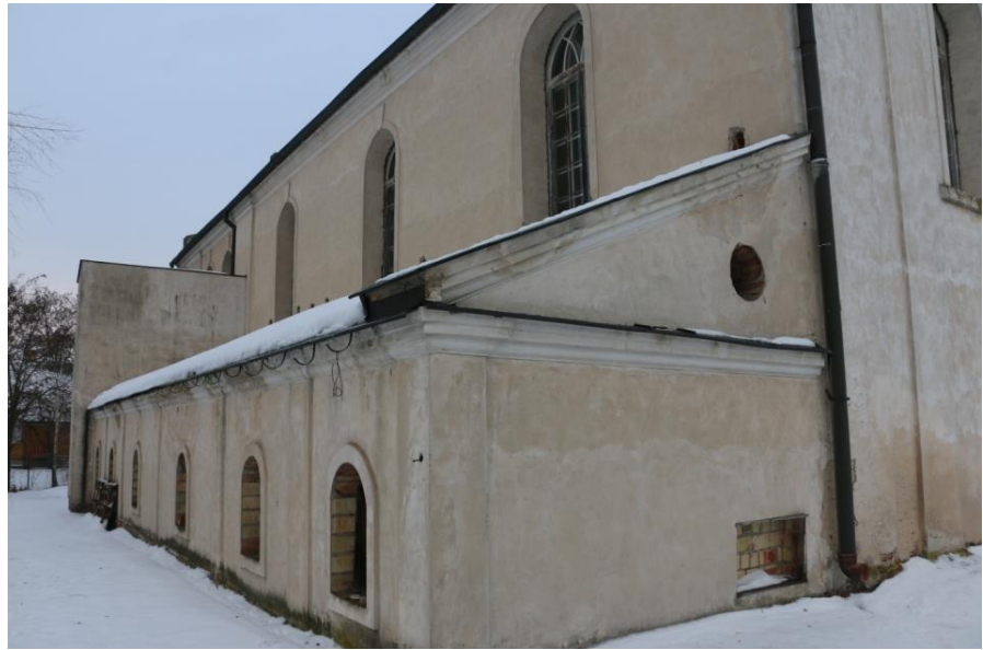
Fot. 27 Zdemontowana rynna i rura spustowa po stronie południowej
