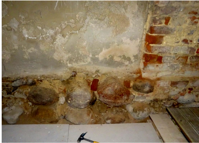
Fot.5 Cokoly z cegły. Intensywny rozwój glonów ( algae ) –i soli bud. Pobrano PRÓBKĘ NR 6 do dalszych badań
