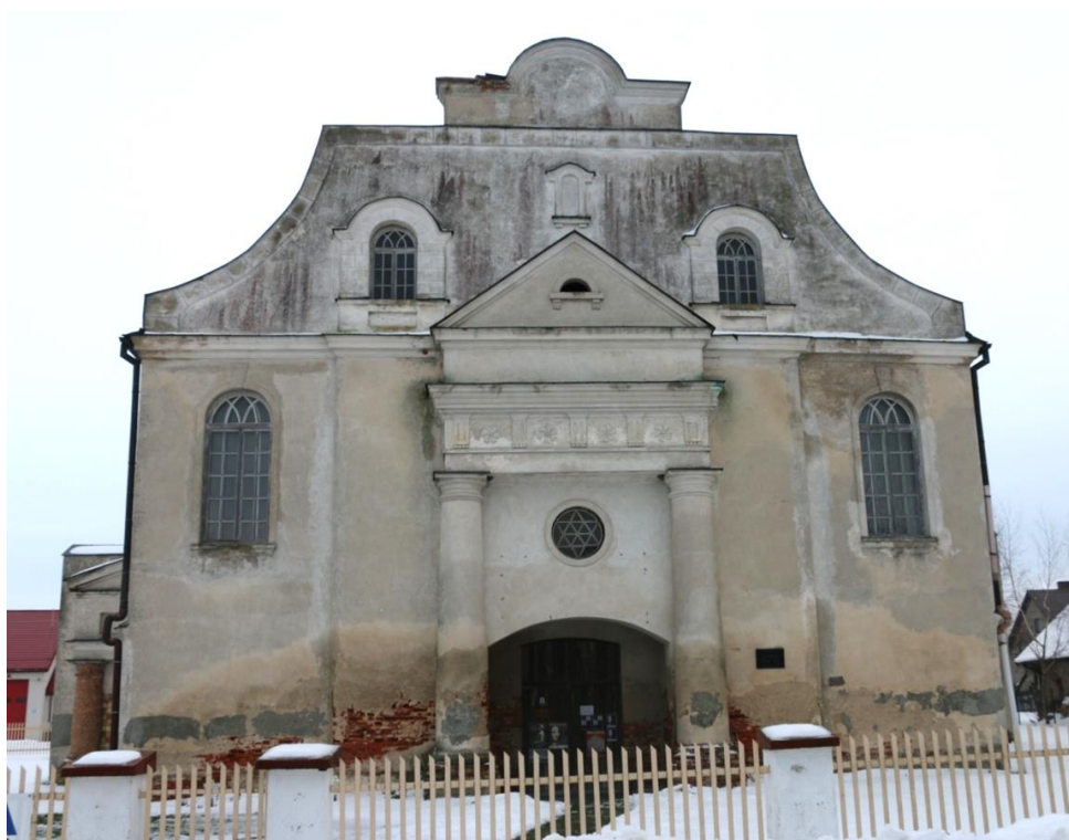
For.2 Ściana frontowa synagogi .Widoczne uszkodzenie cegieł muru i tynków od kapilarnego podciągania wody z gruntu. Fragment ściany szczytowej zamykającej poddasze z licznymi wykwitami glonów ( algae )i grzybów rozkładu plesniowego ( Aspergillus , Turula murorum )
