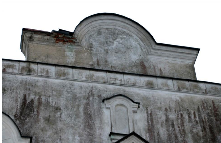
Fot.25 Korozja biologiczna i chemiczna górnej części elewacji frontowej
