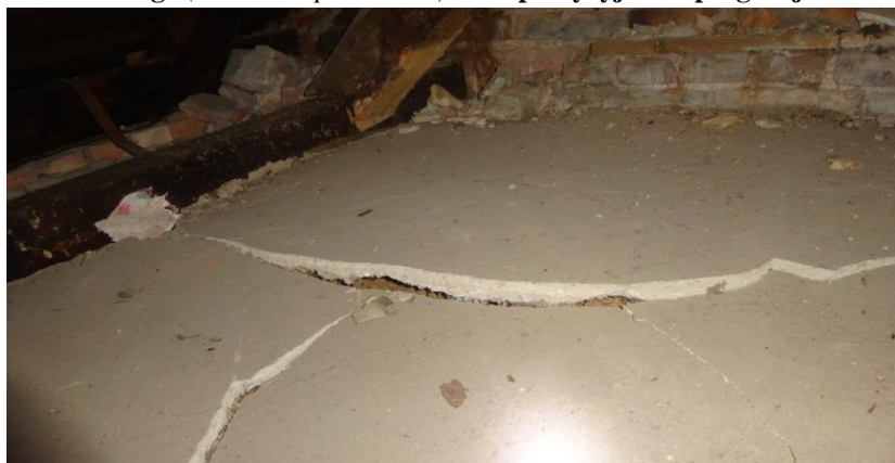
Fot.20 W narożu północno- wschodnim spękana szlichta przykrywająca izolację i wypełnienie sklepienia krzyżowego - z trocin
