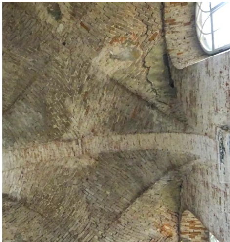
Fot.32 Fragment sklepienia krzyżowego .Widoczne resztki tynku
