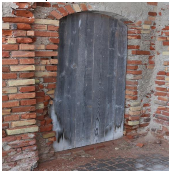
Fot.24 Drzwi uszkodzone przez Grzyb domowy biały ( Poria vaporaria ) i Grzyb rozkładu pleśniowego Aspergillus Niger . Zgnilizna brunatna
