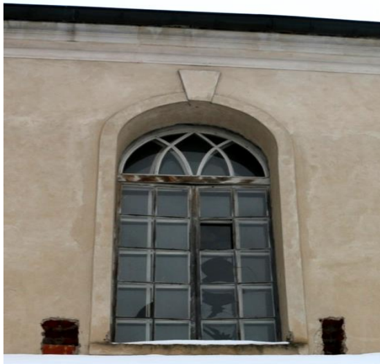
Fot.23 Uszkodzona stolarka okienna , głównie przez Grzyby rozkładu pleśniowego typu Aspergillus Niger i Chaetomium globosum . Uszkodzenie i ubytki w szkleniu.
