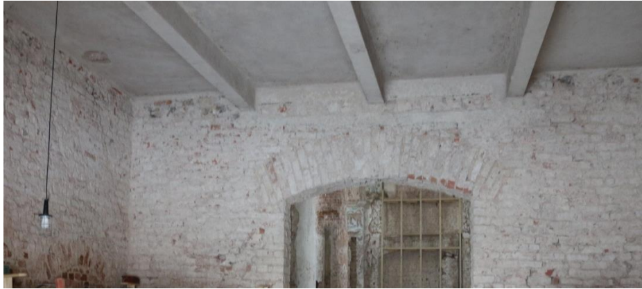
Fot.13 Strop nad przedsionkiem –żelbetowy strop płytowo-belkowy. Stan techniczny - zadawalający
