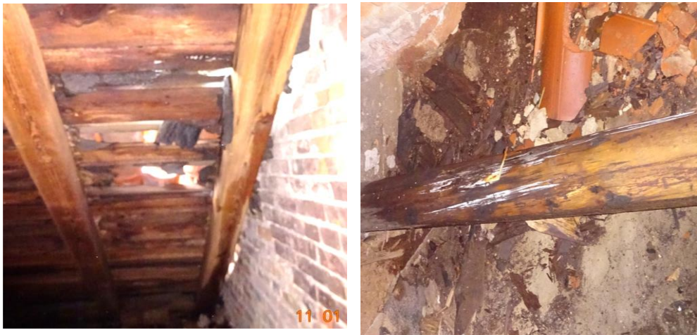
Fot.18 Uszkodzenie pokrycia po stronie południowej w wyniku , którego rozwinął się na elementach drewnianych Grzyb domowy biały ( Poria vaporaria ) PRÓBKA NR 1
